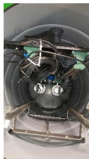
Helyesen telepített szivattyúk
